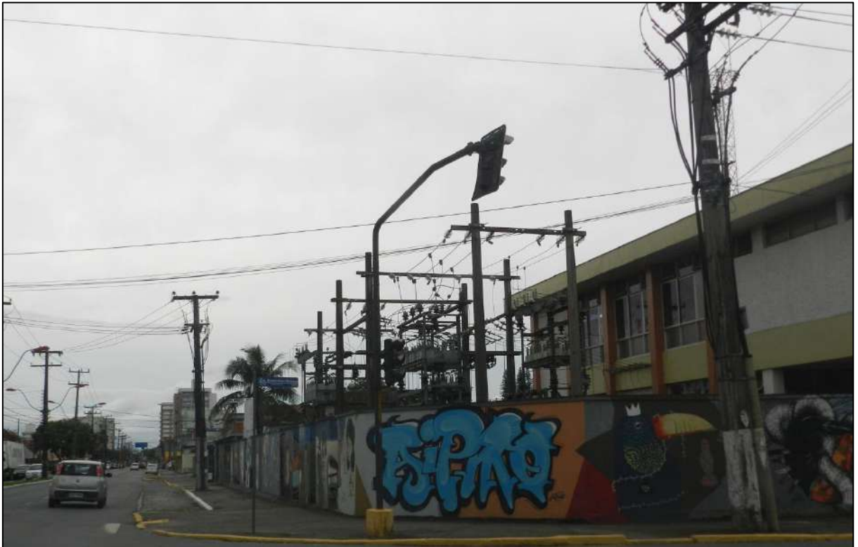
Figura 55: Uso de Serviços – Energia Elétrica (Ponto 23).
