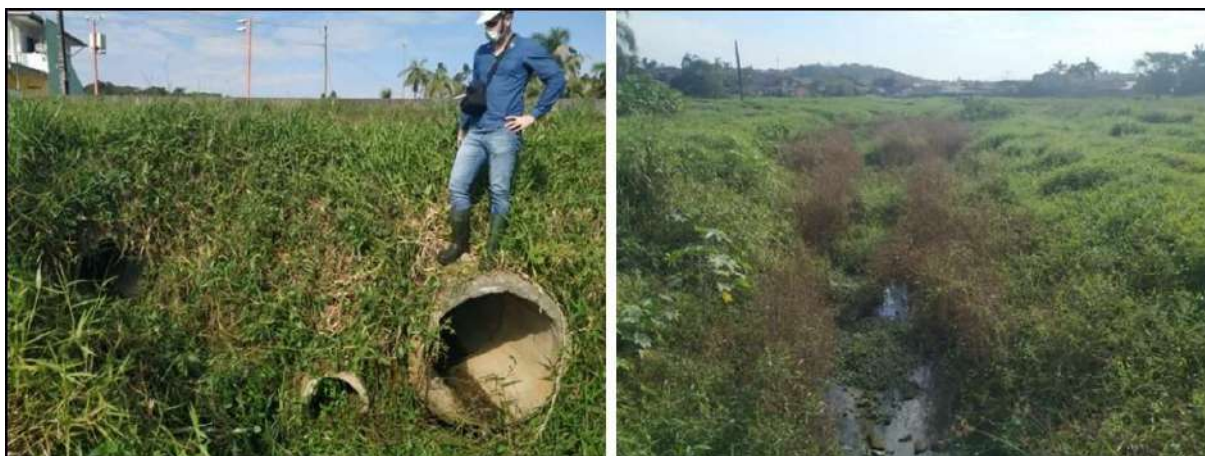
Figura 33. Início da vala de drenagem no imóvel com contribuição de água da drenagem pluvial. Fonte: DBIO, 2020.
