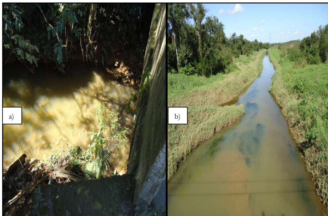
Figura 4.18 - Rio Piraí: a) Trecho subdimensionado, local de extravasamento. B) Excesso de sedimentos.
