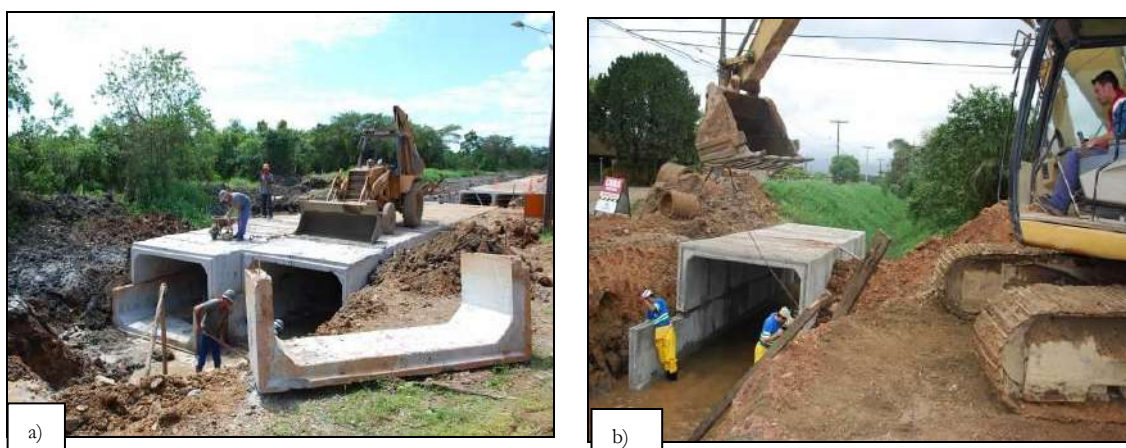
Figura 5.3 – Medidas intensivas: a) Obras de macrodrenagem na rua Noruega - Bairro Boa Vista. Foto: Naiara Larsen. b) Galeria Vila Nova. Foto: Ruy Ferrari.
