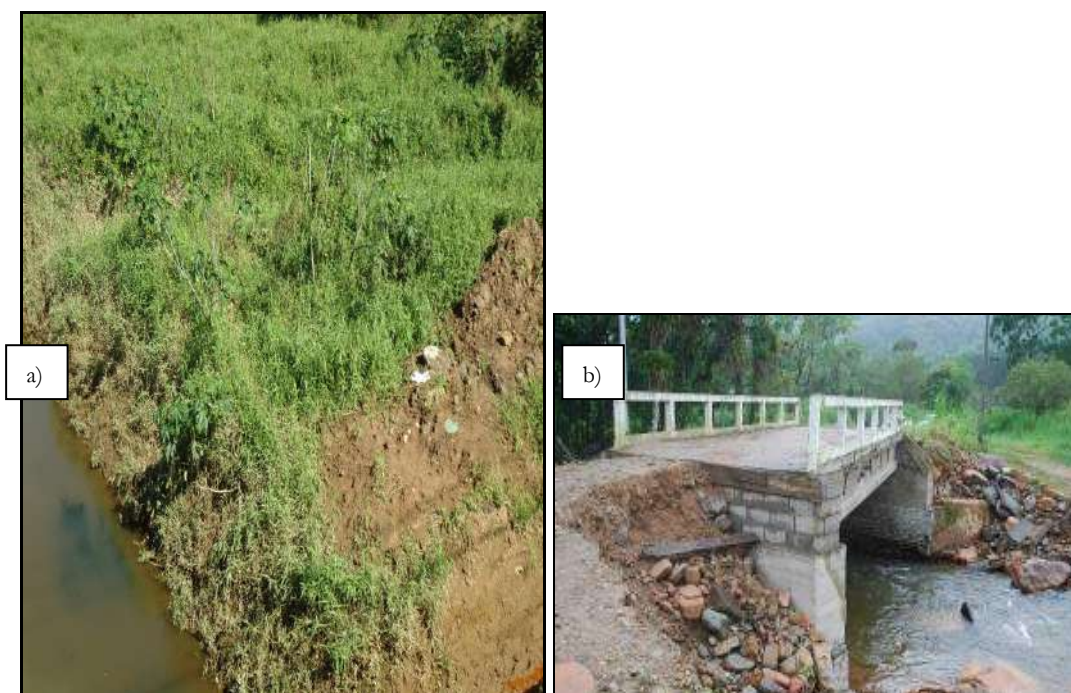
Figura 4.19 – Rio Pirai: a) Erosão da margem causada pela ausência de mata ciliar. B) Destruição de ponte causada por enxurrada do rio Pirai, em 2012.
