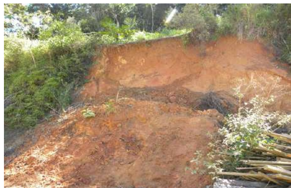
Foto 2-82: Detalhe de escorregamento circular, com movimentação de solo e rocha saprolítica (ver volume acumulado ao pé do talude). Situação decorrente da exposição do material em talude de corte subvertical (modificando a condição natural), observado na região de São Brás, município de Navegantes/SC.22 J 717762 m E 7038797 m S.
