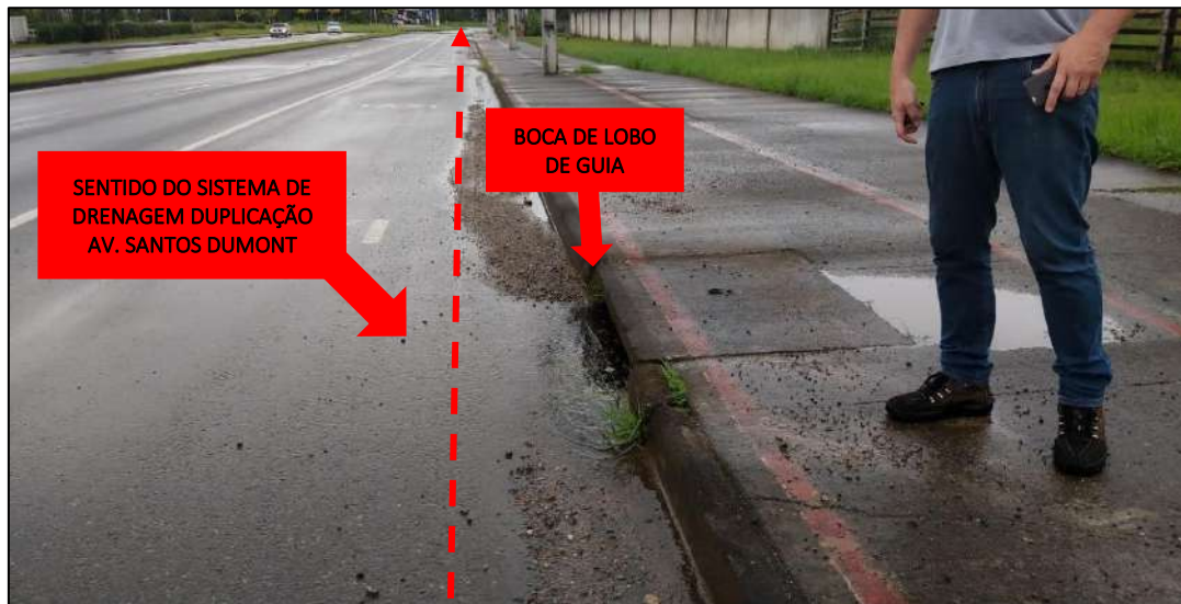
Figura 15: Boca de lobo que prossegue a drenagem em frente ao Centro de Eventos Sítio Novo, responsáveis por contribuir com a vala de drenagem que se defronta com o terreno da área do imóvel. Fonte: Bioeco, fotografia realizada no dia 15/03/2022.
