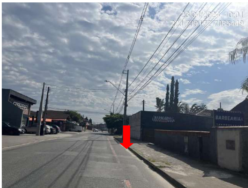
Figura 72: Ciclofaixa na rua Pitaguaras. Observa-se que a pintura está desgastada.
