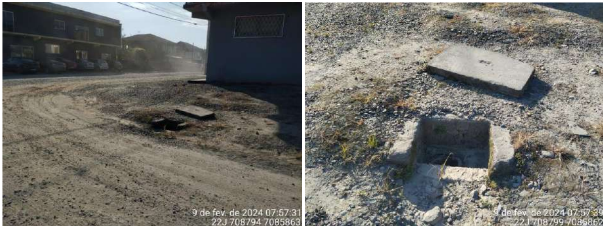
Figura 35: Boca de lobo na rua Cleci Borges, esquina com a rua Porfíria Alves de Lima.
