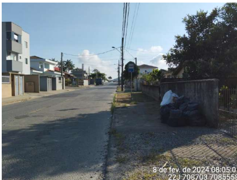
Figura 16: Calçada irregular na rua Lagoinha, vista para rua Porfíria Alves de Lima.
