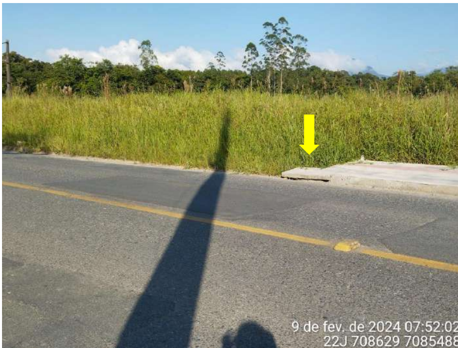
Figura 30: Boca de lobo em frente ao imóvel em estudo, rua Lagoinha.
