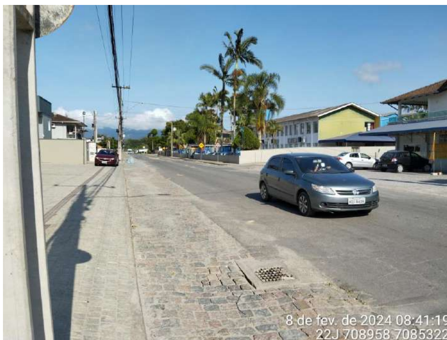
Figura 32: Boca de lobo na Rua Minas Gerais, próximo a Escola Municipal Professora Elizabeth Von Dreifuss.
