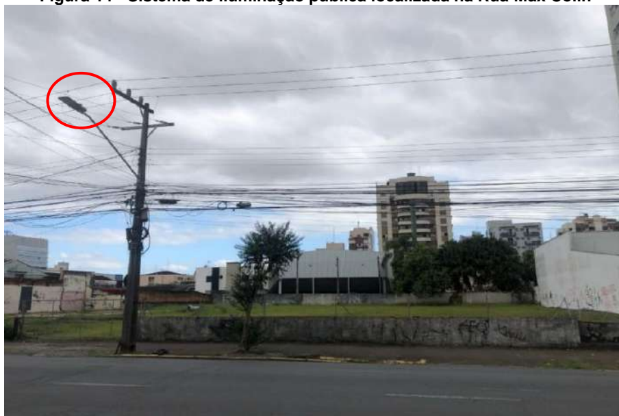
Figura 14 - Sistema de iluminação pública localizada na Rua Max Colin
