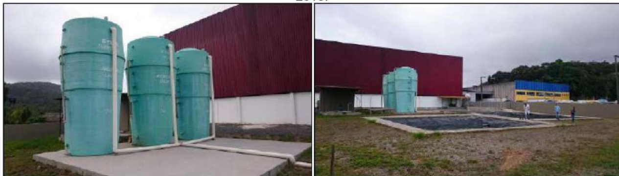
Figura 8. Registros fotográficos da ETE existente nas dependências da fábrica. Fonte: Acervo fotográfico, 2015.
