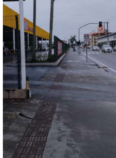
Piso tátil direcional quando de aberturas de acesso para veículos. Calçada mesmo recebendo grandes contribuições de carga em bom estado.
