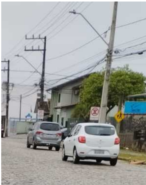
Iluminação pública no lado oposto ao empreendimento.
