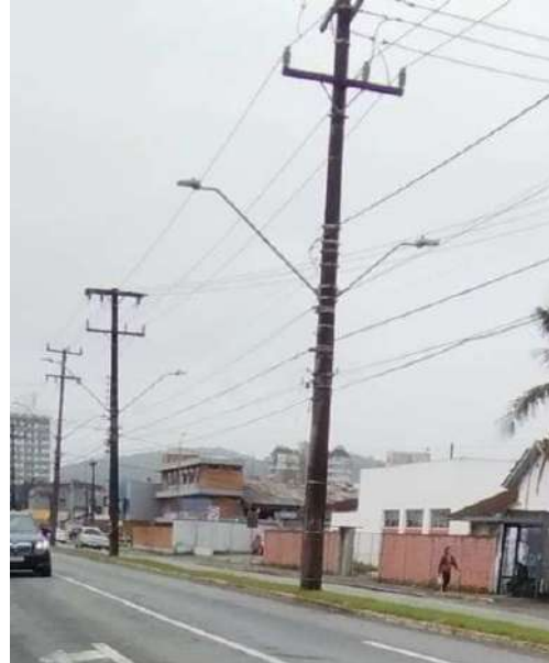
Iluminação pública com LED no canteiro central da avenida, em ambos os sentidos da via.
