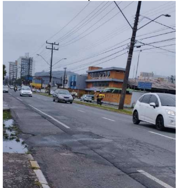
Pavimento asfáltico com alguns sinais de reparos e rachaduras, mas com boa cobertura nas demais regiões.
