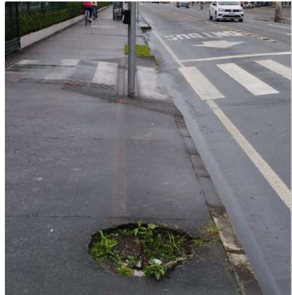
Buraco em calçada
