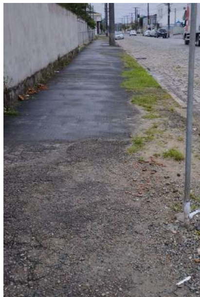
Calçada com pavimento danificado
