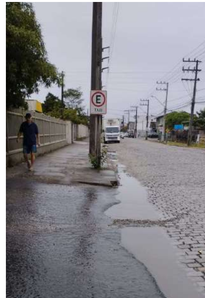
Encontro asfalto de estacionamento da saída do Fort com o pavimento de paralelepípedo da Rua.
